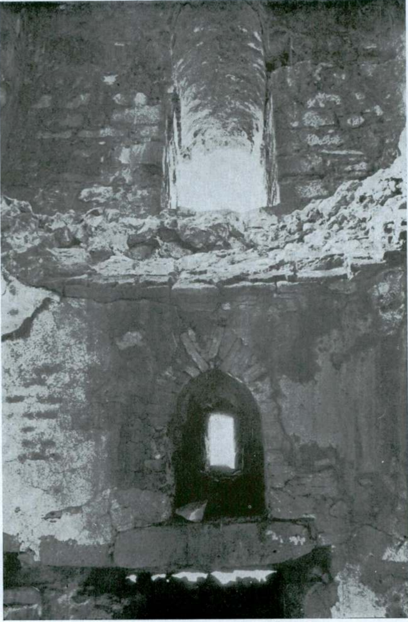
Resim 15 — Birinci Kat Döşemesinin Çökmüş Olan Ön Kısmından Görünüş ve Zemin Kattaki Güneybatı Yönüne Açılan Sivri Kemerli Mazgal Pencere
