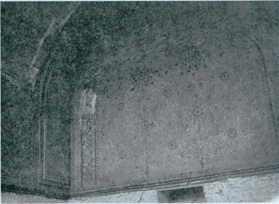
Res. 19 — Konya Sırçalı Medrese. Eyvanın batı duvarında çini bezemeleri (onarımdan önce).
