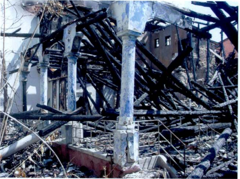
Resim 2: Yangın Sonrası Konağın
